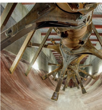
Mezclador de paletas en un sistema de fermentación en seco
