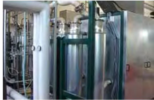
Biodiesel Erneuerbare Energien Blockheizkraftwerke (BHKW)
