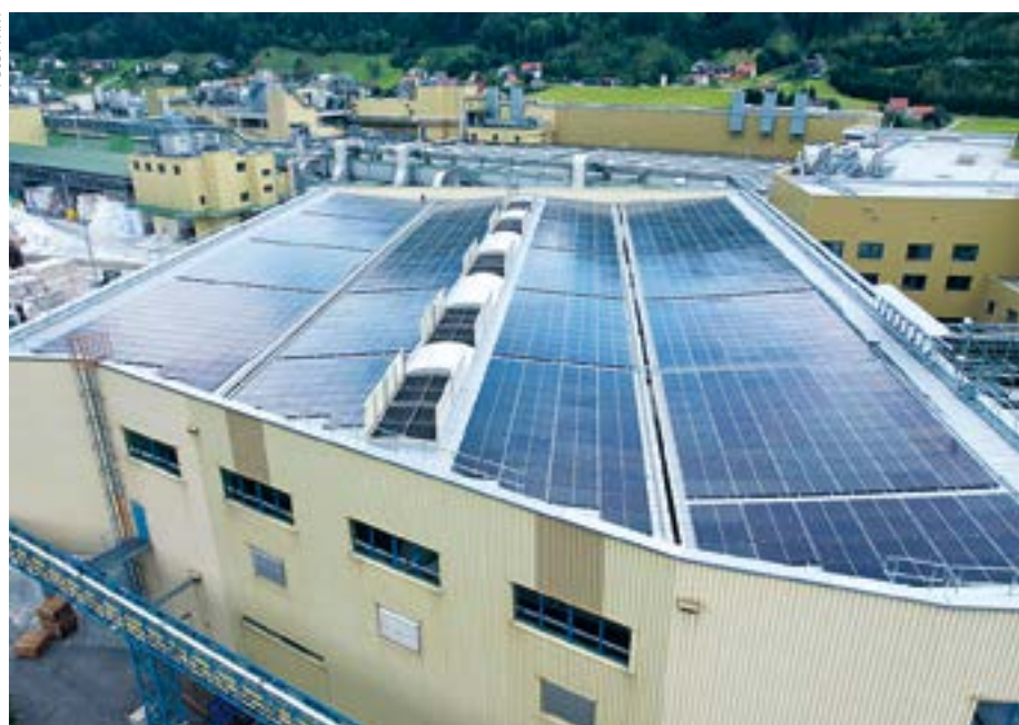
Die 2023 in Betrieb gegangene PV-Anlage in Frohnleiten liefert 3 MWh im Jahr, jetzt überlegt Mayr-Melnhof einen weiteren Ausbau.
