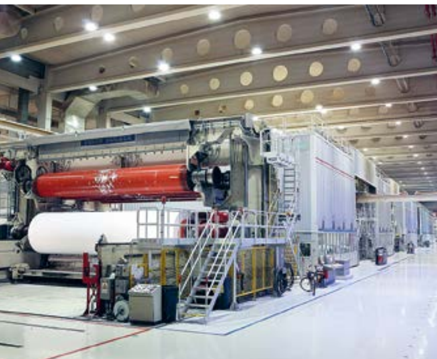
In Gratkorn wurden Schalldämpfer im Bereich der Hallenabluft-Leitungen, der Zellstoff-Entwässerungsmaschine und beim Säurepuffer-Behälter nachgerüstet.
